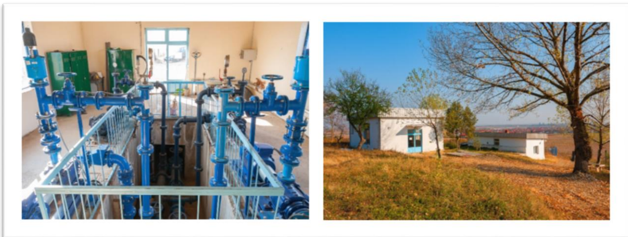
Слика 10. Пумпне станице и резервоар
